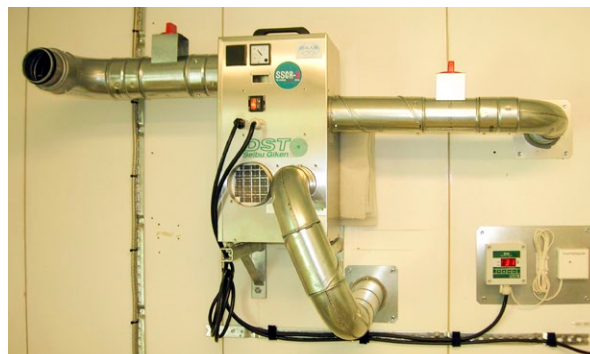
DR-010B varustettuna EH4 hygrostaatilla kontrolloii pumppuaseman kosteutta
