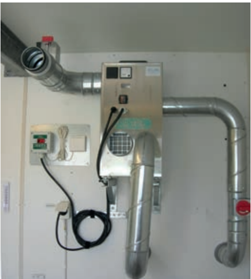
Ilmankuivain mallia DR-10B asennettuna paineenkorotus asemalle ja liitettynä EH4:een.
