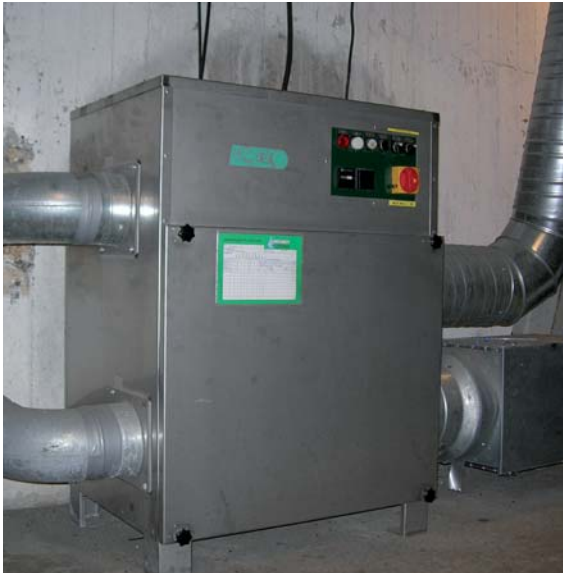
Liljeholmin sillan sisusta suojataan korroosiolta DST-kuivaimen avulla.
