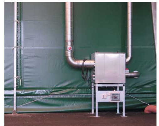
DST-kuivain tyyppiä Recusorb DR-40 asennettuna muovihalliin.
